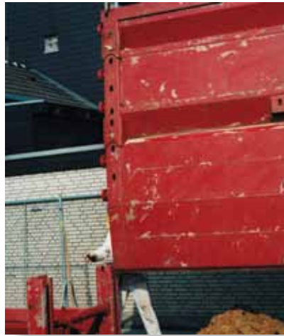
Cada lado del conjunto del módulo de entibación se monta separadamente y se baja poco a poco hasta alcanzar la profundidad de excavación de la zanja.
