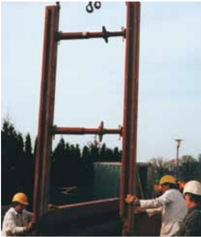
Un módulo de paneles y codales se sitúa en una preexcavación realizada en la zanja y sirve como punto de partida para insertar la primera guía deslizante.
