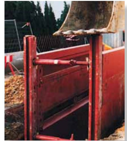
La guía deslizante va bajando a medida que va progresando la excavación.
